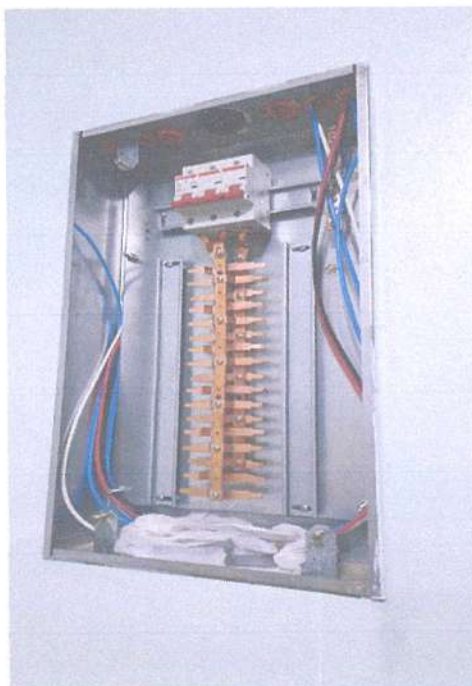
Imagem 04 - Quadro de distribuição novo.
